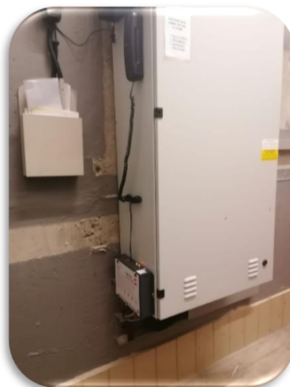
Safeline SL6 verbaut im Maschinenraum
