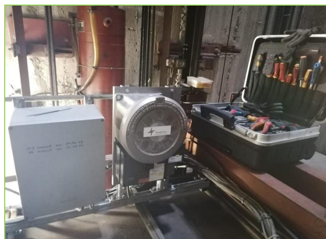
Notrufsystem Telegärtner NRT 1 Ex G3 für explosionsgefährdete Bereiche: Installiert auf der Aufzugskabine
