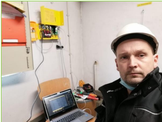
UNSer Obermonteur Robert bei der Programmierung der neue Notrufsysteme
